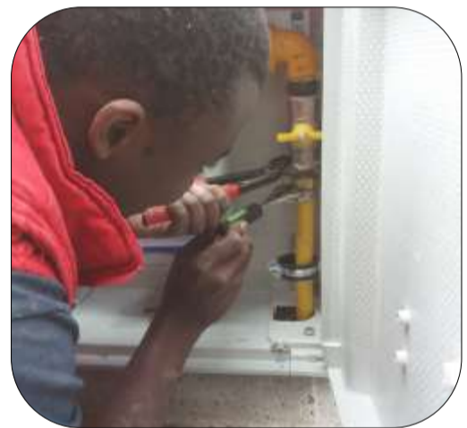
Raccordement d'un compteur de gaz
